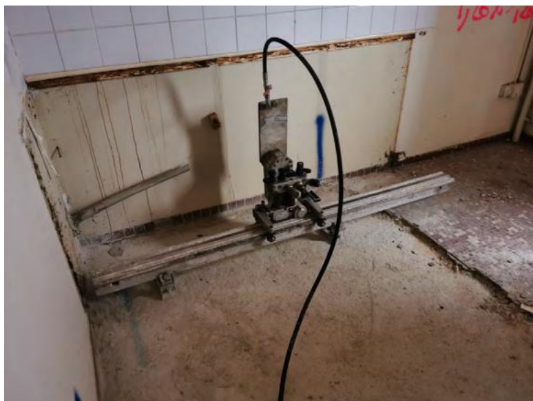
Installation du rail de guidage pour sciage de la dalle- Crédit : Sodeka
