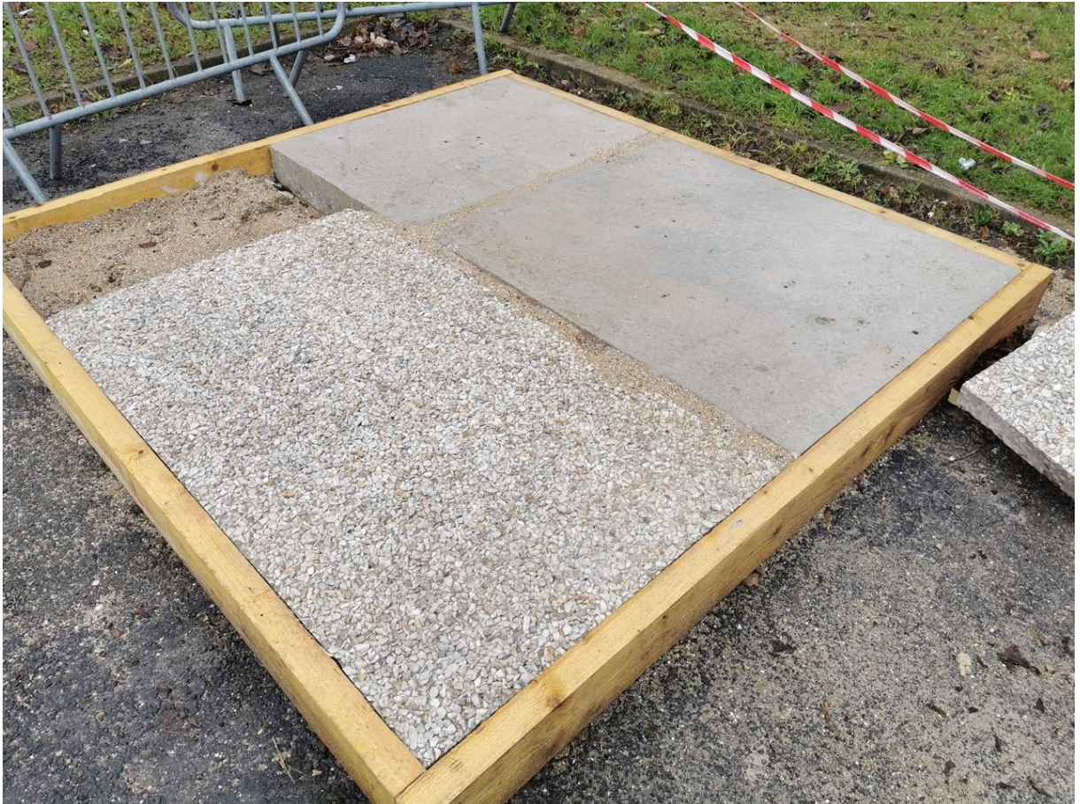
Pose des prototypes sur lit de sable (au premier plan, panneau de façade) - Crédit : Bellastock
