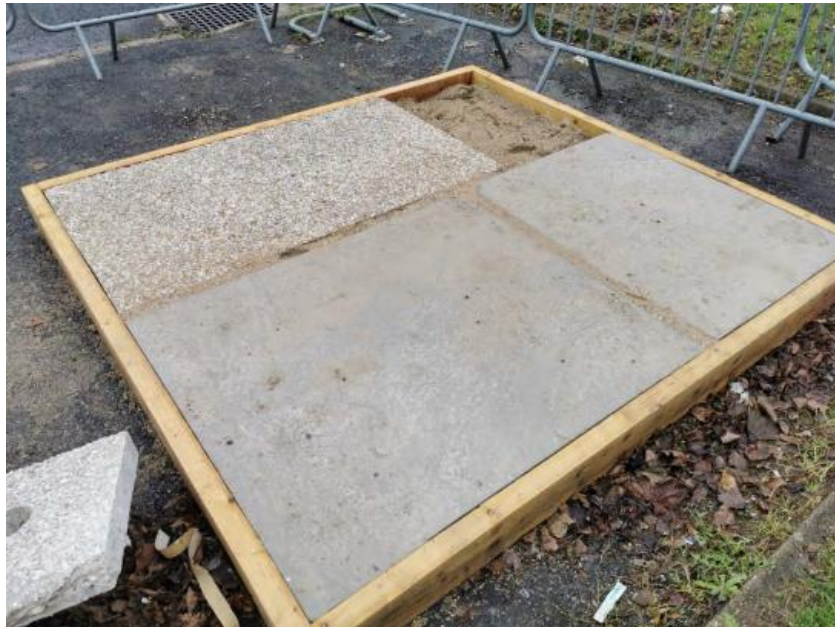
Pose des prototypes sur lit de sable (au premier plan, dalle de plancher) - Crédit: Bellastock
